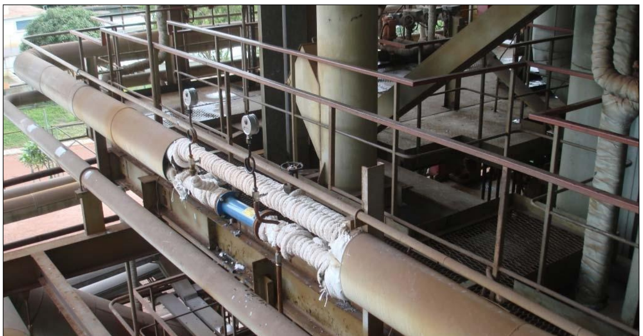
Figura N°1 Instalación del aparato de homogenización en la caldera N°5
